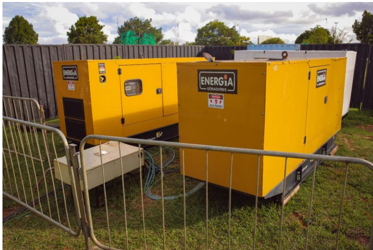
Figura 16 – Estrutura de gerador com tanque de armazenamento de óleo
